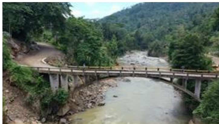
Gambar 1.1 Masalah gerusan di sungai Cimadur
